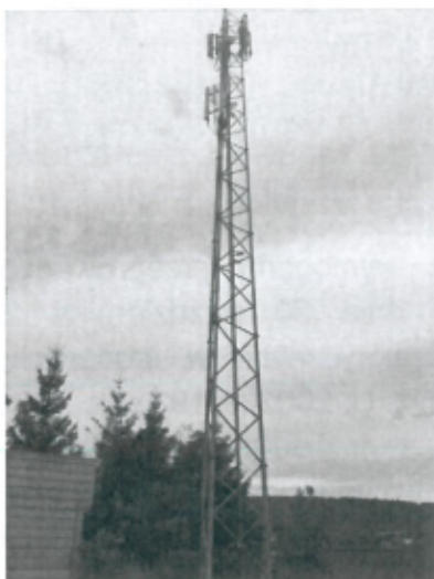
Widok obiektu wraz z zainstalowanym zespołem antenowym
