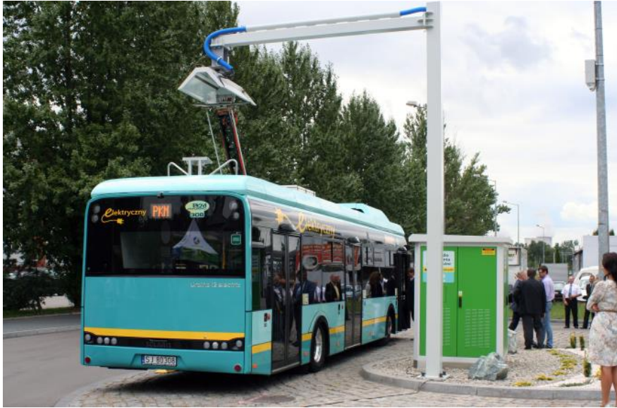
Rysunek 10: Pantografowa stacja ładowania autobusów elektrycznych w Jaworznie (źródło: https://www.transport-publiczny.pl/img/jaworznostacja1.jpg 678-443.jpg)
